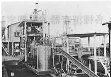
廃プラスチック熱分解装置
