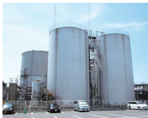
嫌気性廃水処理システム
