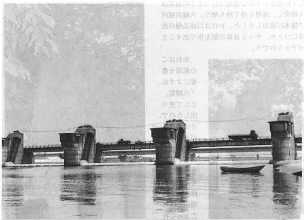
行徳橋ローリングゲート
