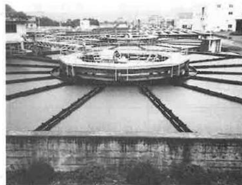
佐倉浄水場高速沈殿池
