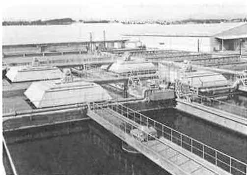
繊維工場廃水処理プラント
