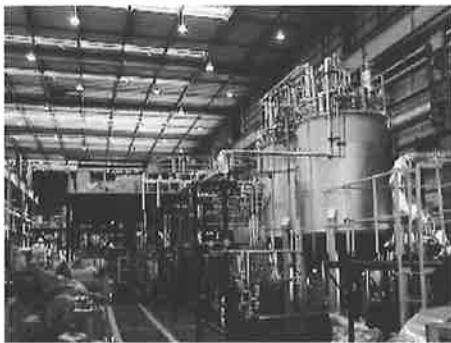
エタノール製造実証プラント (提供：月島機械株式会社)
