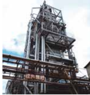
排熱回収ボイラー
