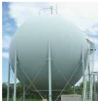
かん水から分離精製された 天然ガスの球形貯蔵施設
