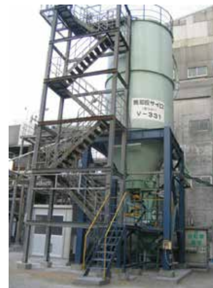
新たに稼働を開始した焼却灰受け入れ施設
