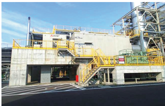
蒸気タービン発電設備
