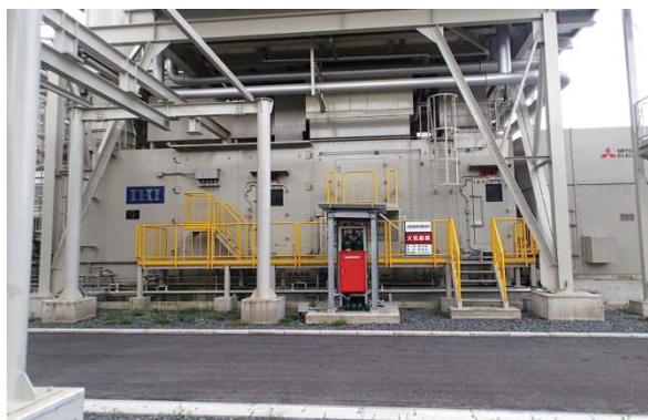
ガスタービン発電設備
