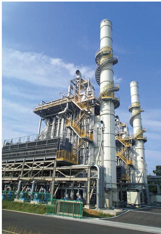
排熱回収ボイラ
